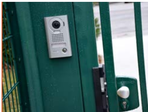
Les six groupes scolaires ont été équipés de portillons à verrouillage électrique et serrures électroniques permettant un contrôle d'accès.
